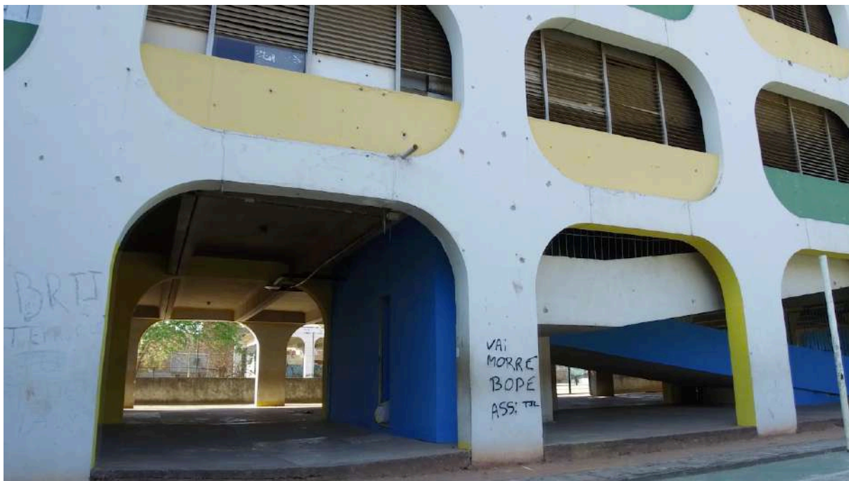
Figura 32: Fachada de escola atingida durante conflitos armados na Maré | Autor: Diego Alves (ECOM, 2017)
