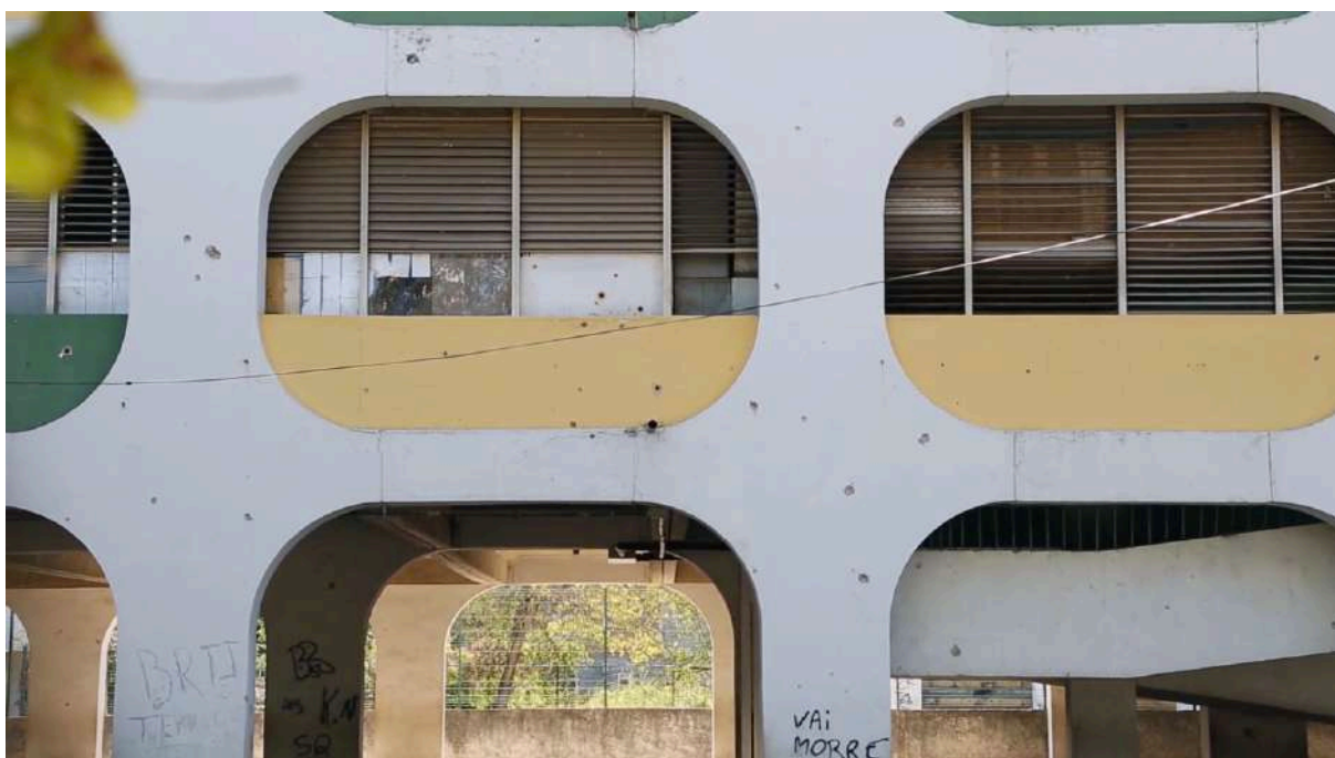
Figura 33: Fachada de escola atingida durante conflitos armados na Maré | Autor: Diego Alves (ECOM, 2017)
