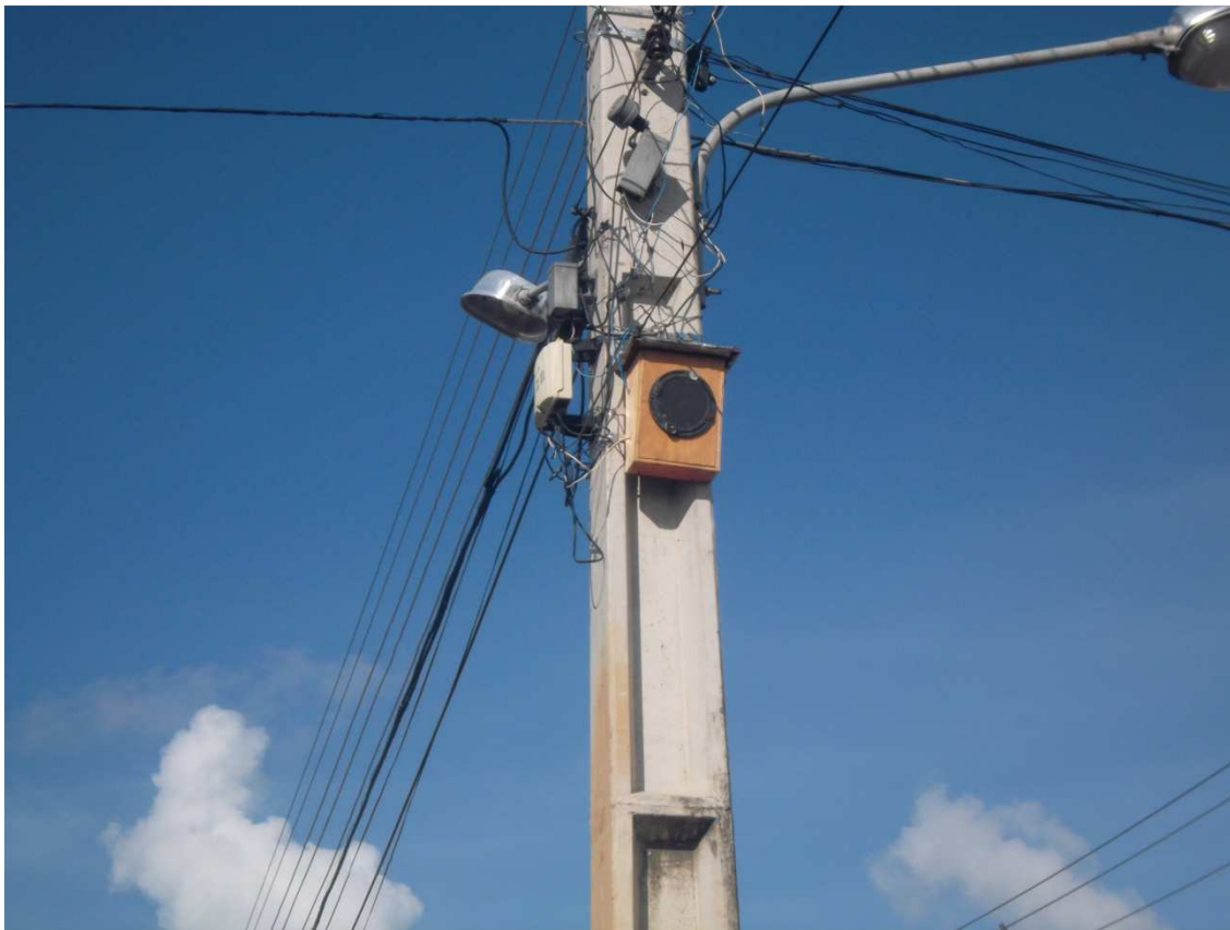
Caixa de Som da Rádio E.C Som instalada em um Poste de eletricidade
