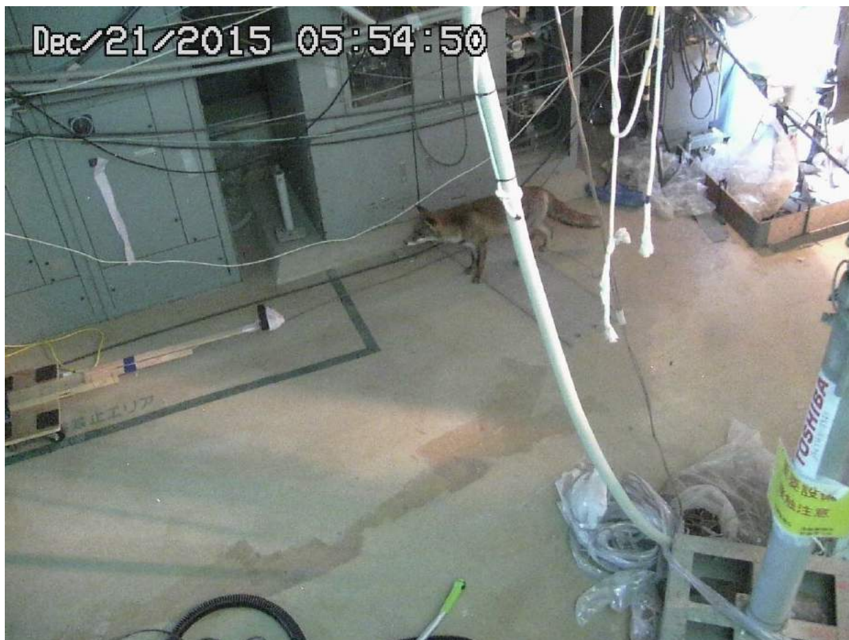
Figura 45 - Zorro filmado por una cámara de vigilancia del reactor 2 de Fukushima Daiichi. Fuente: TEPCO.
